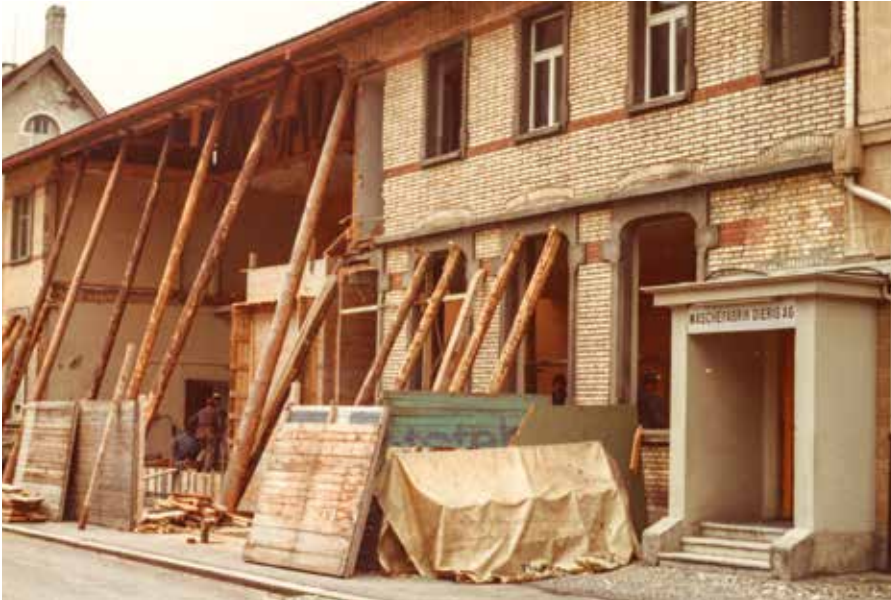
Der Einsturz ging zum Glück glimpflich aus, niemand kam zu Schaden.
